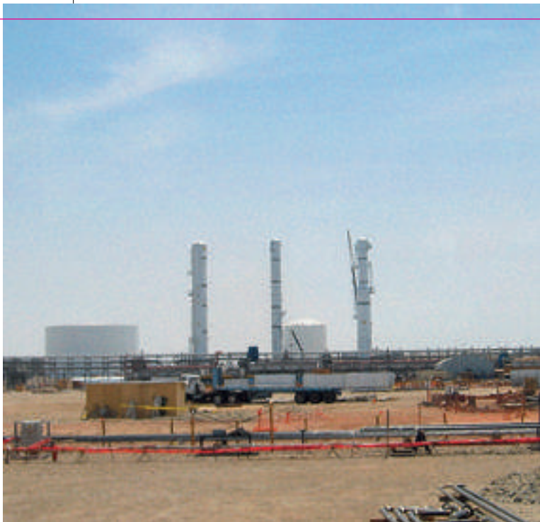
Transportadora de Gas del Perú S.A.
